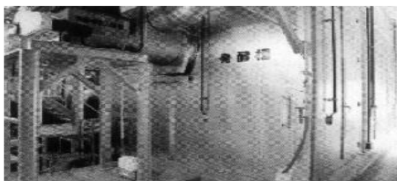
有機肥料製造途中(発酵槽)
