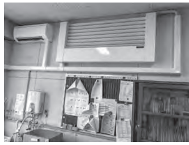
▲室内空気の対流が発生しない放射式の空調設備
