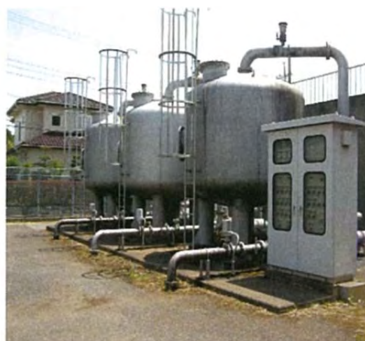
写真2.2.2 第2配水場急速ろ過機
