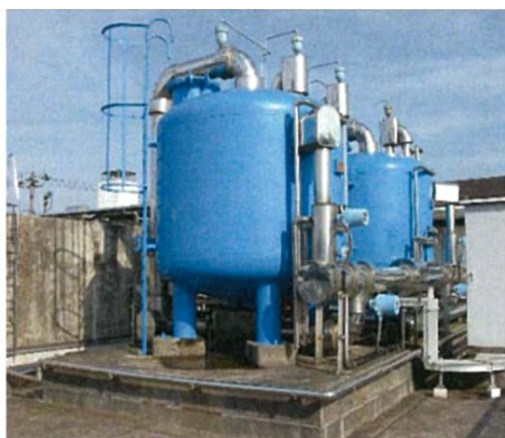
写真2.2.1 第1配水場急速ろ過機
