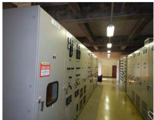
写真 2.2.4 第2配水場1系電気設備
