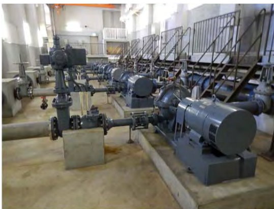
写真 2.2.3 第2配水場1系配水ポンプ
