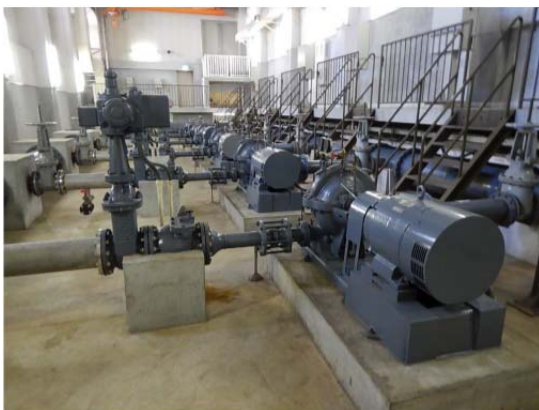
写真 2.2.3 第2配水場1系配水ポンプ
