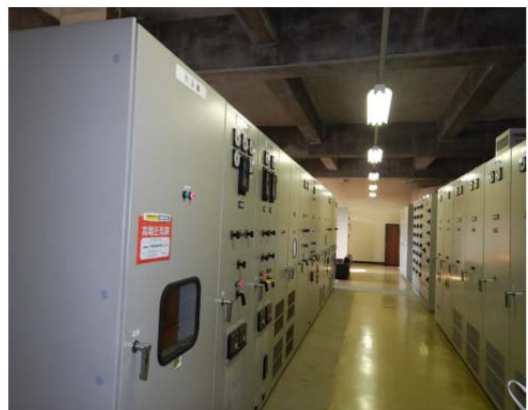
写真 2.2.4 第2配水場1系電気設備
