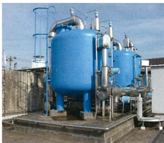
写真2.2.1 第1配水場急速ろ過機
