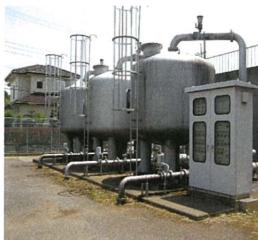
写真2.2.2 第2配水場急速ろ過機
