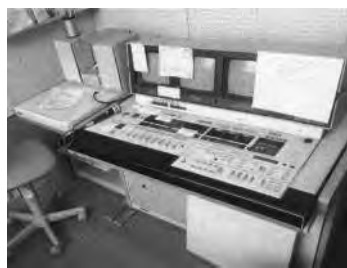
▲改修を待つ放送設備
