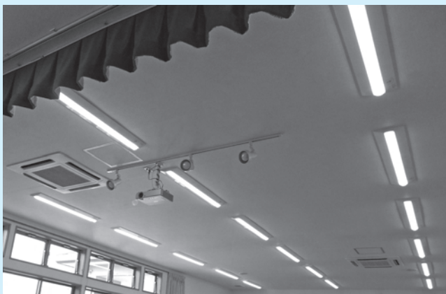
照明器具をLEDに交換
