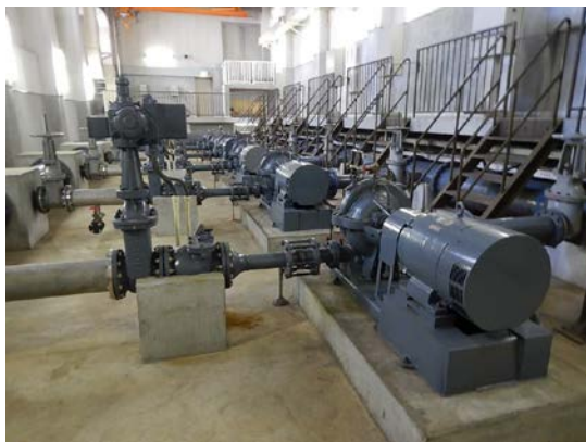
写真 2.2.3 第2配水場1系配水ポンプ
