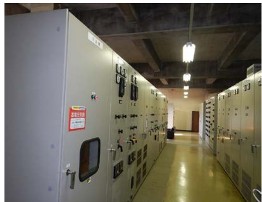
写真 2.2.4 第2配水場1系電気設備
