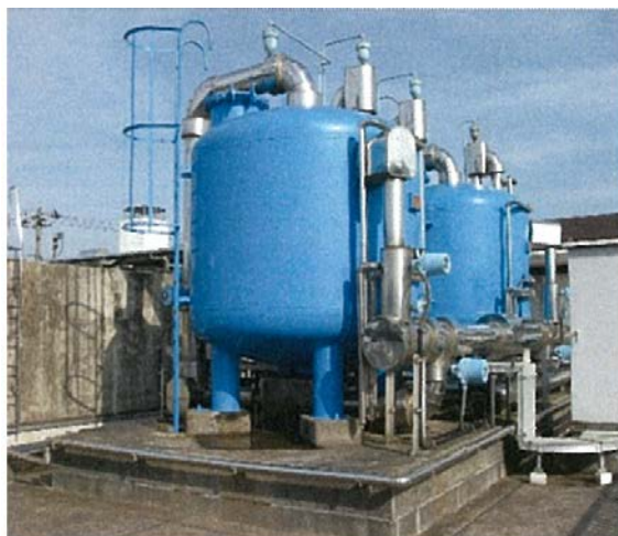
写真2.2.1 第1配水場急速ろ過機
