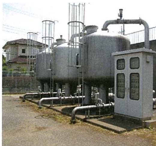
写真2.2.2 第2配水場急速ろ過機
