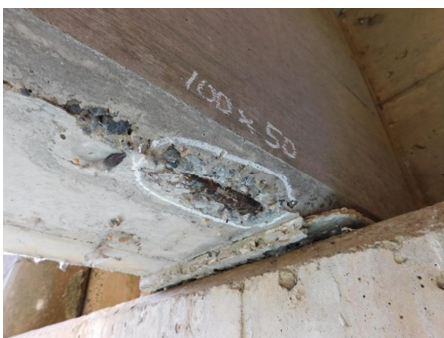
橋No.2_きさらぎ橋(健全性Ⅱ) (主桁) 剥離・鉄筋露出
