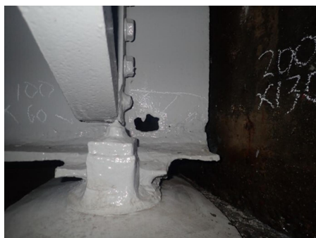
橋No.11_八街跨線道路橋(健全性Ⅲ) (主桁) 変形・欠損
