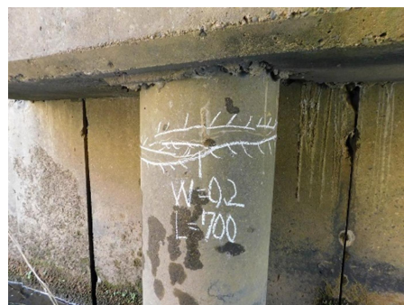
橋No.25_城之内橋(健全性Ⅱ) (下部工) 遊離石灰・ひびわれ
