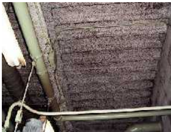
石綿含有吹付けロックウール
