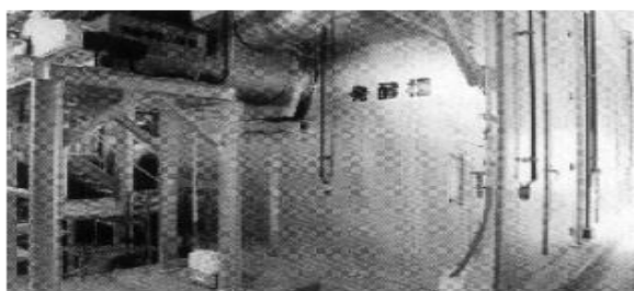
有機肥料製造途中(発酵槽)
