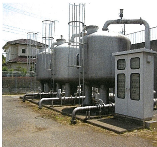
写真 3.4.2 第2配水場急速ろ過機
