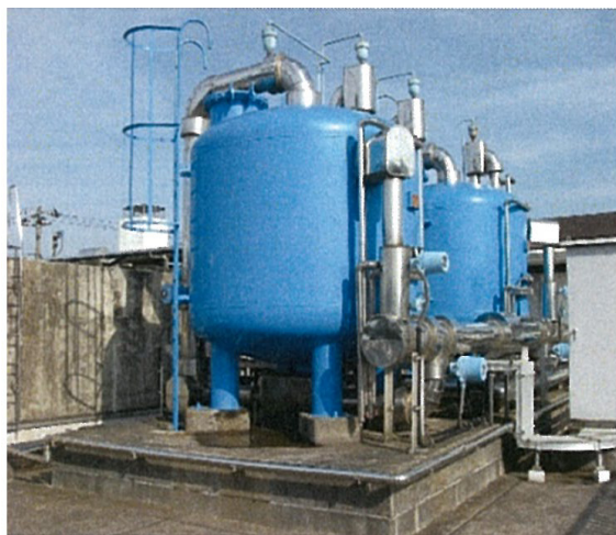
写真 3.4.1 第1配水場急速ろ過機
