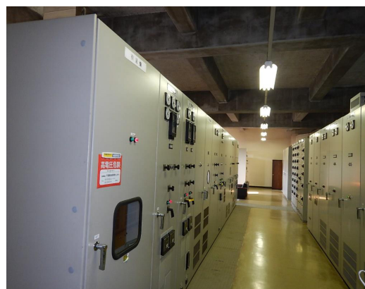
写真 3.2.4 第2配水場 1系電気設備
