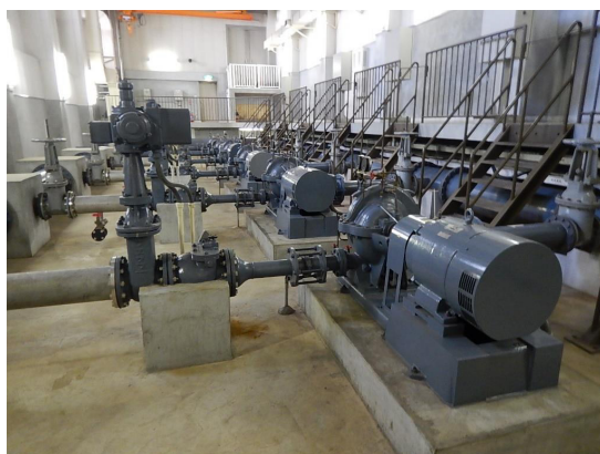
写真 3.2.3 第2配水場 1系配水ポンプ
