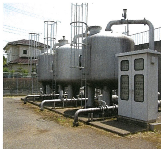
写真 3.2.2 第2配水場急速ろ過機
