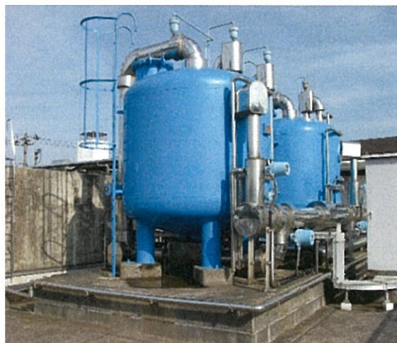
写真 3.2.1 第1配水場急速ろ過機
