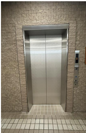
更新工事後第 1 庁舎エレベータ
