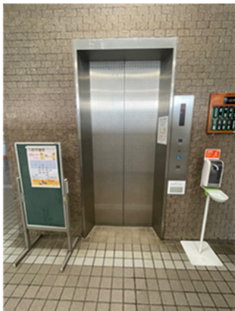
経年劣化している第1庁舎エレベータ
