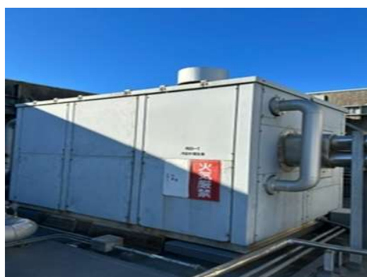
老朽化している総合保健福祉センターの空調設備
