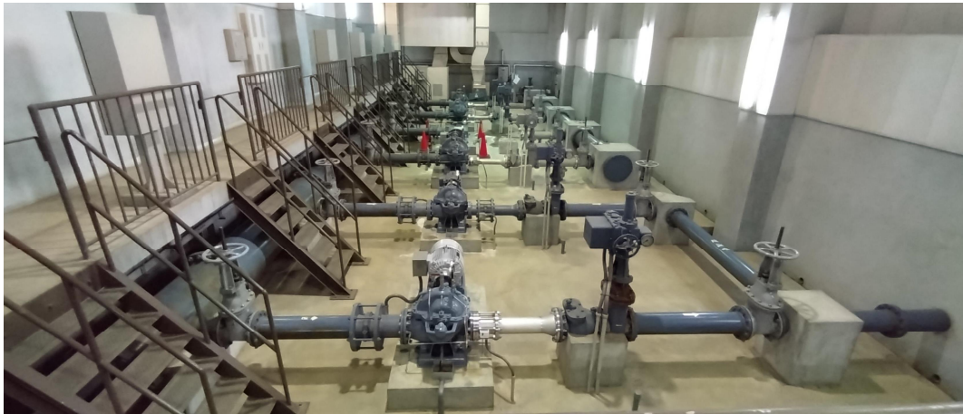
榎戸配水場 1系配水ポンプ
