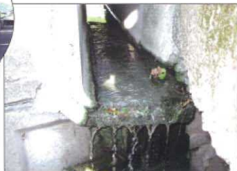
1970年代 単独処理浄化槽設置地域の側溝の例 (白っぽいヘドロ状のものが堆積しています)
