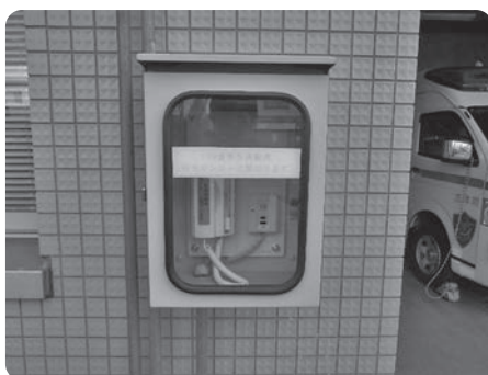
駆付け通報装置
